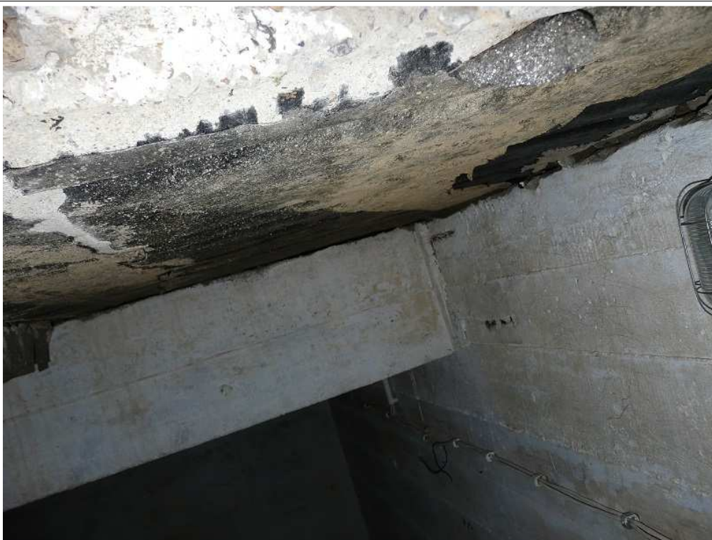
23. Komora techniczna - strop i porośnięcia na ścianie.
