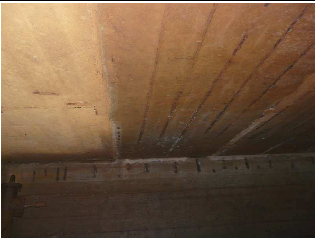
9. Komora nr1 - strop monolityczny z lewej strony, strop prefabrykowany z prawej, odkryte zbrojenie skosu ściany centralnej.
