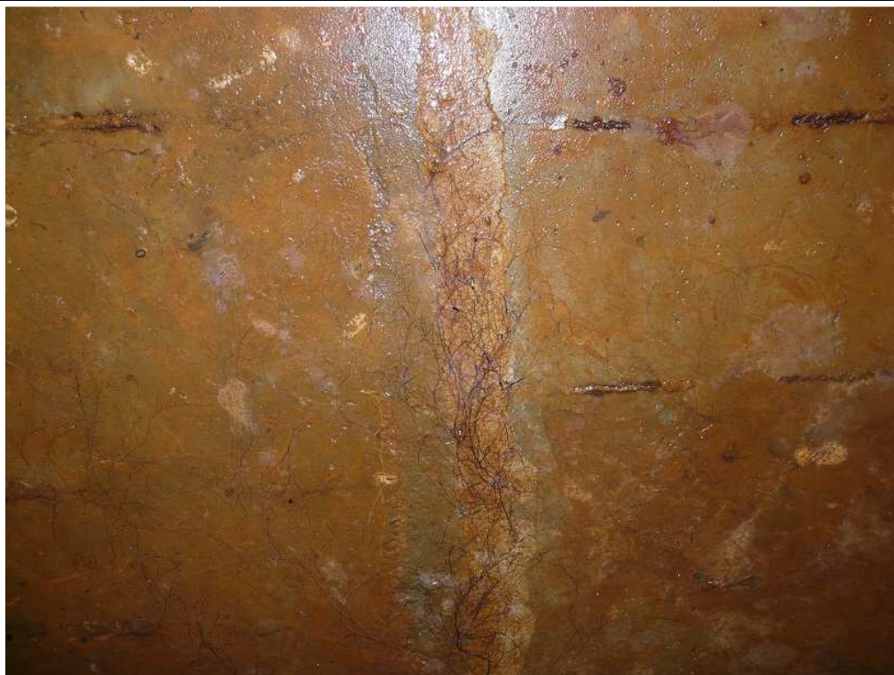
20. Komora nr2 - korzenie lub grzyb na połączeniu płyt stropowych.
