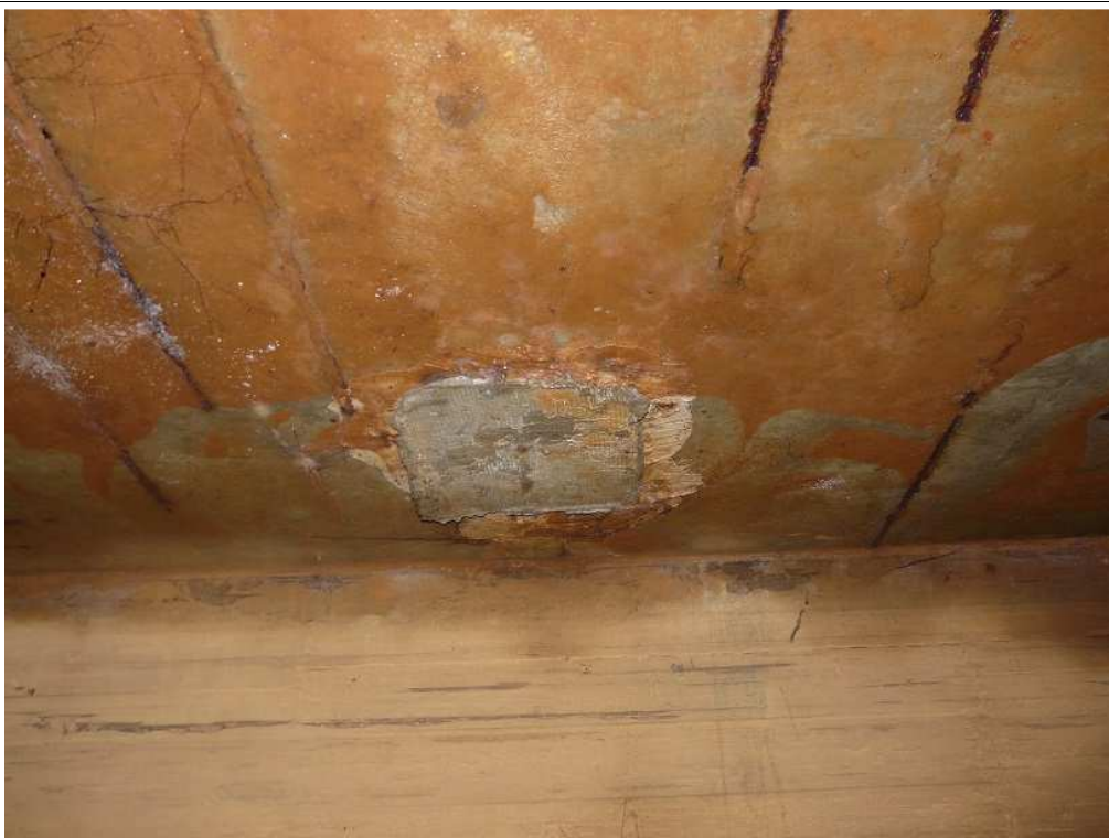
10. Komora nr1 - strop prefabrykowany, z lewej strony korzenie lub grzyb, zaślepiony wlot wywiewki.
