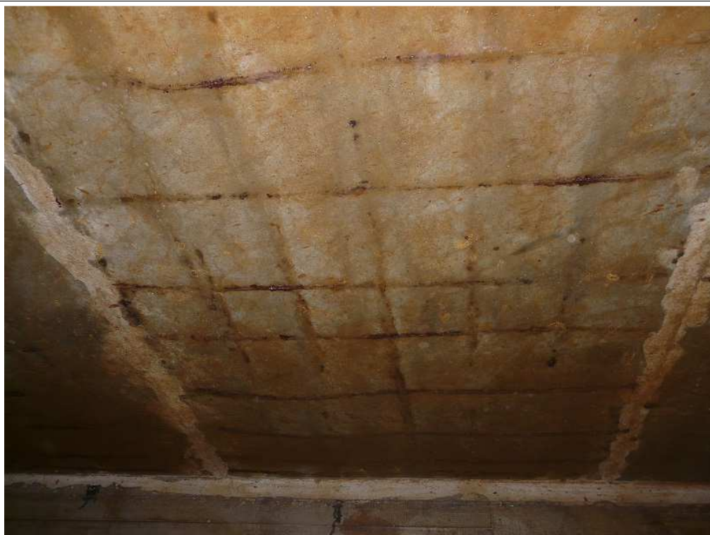
19. Komora nr2 - skorodowane i odsłonięte zbrojenie płyty stropowej kanałowej.
