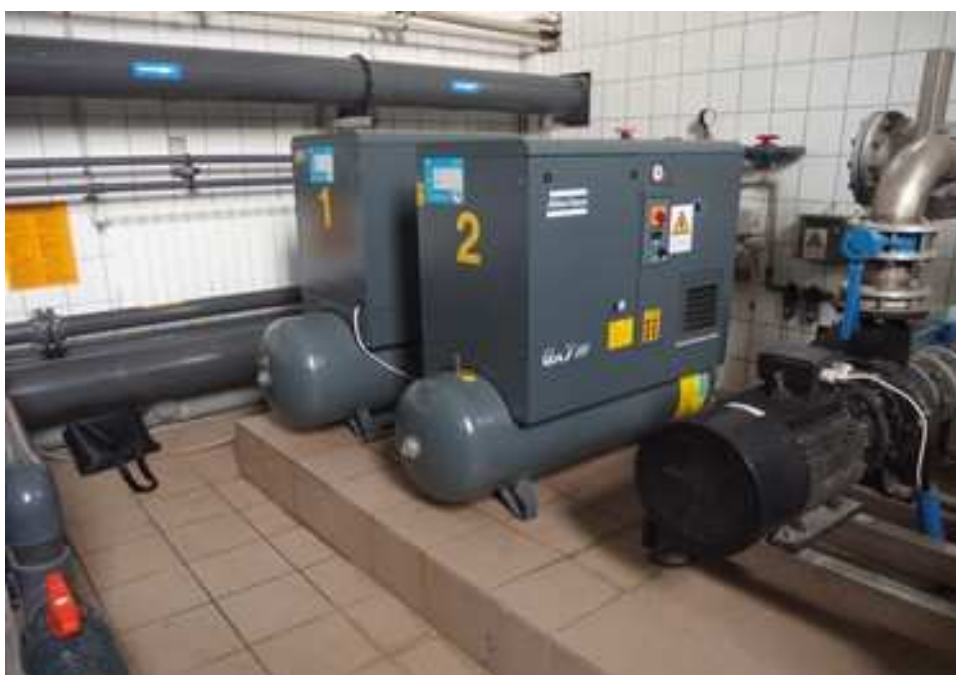
Zdjęcie 2. Sprężarki powietrza na SUW Graniczna
