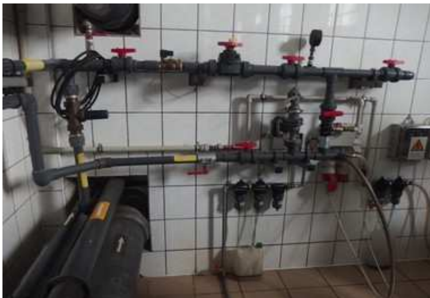
Zdjęcie 4. Węzeł sprężonego powietrza na SUW Graniczna
