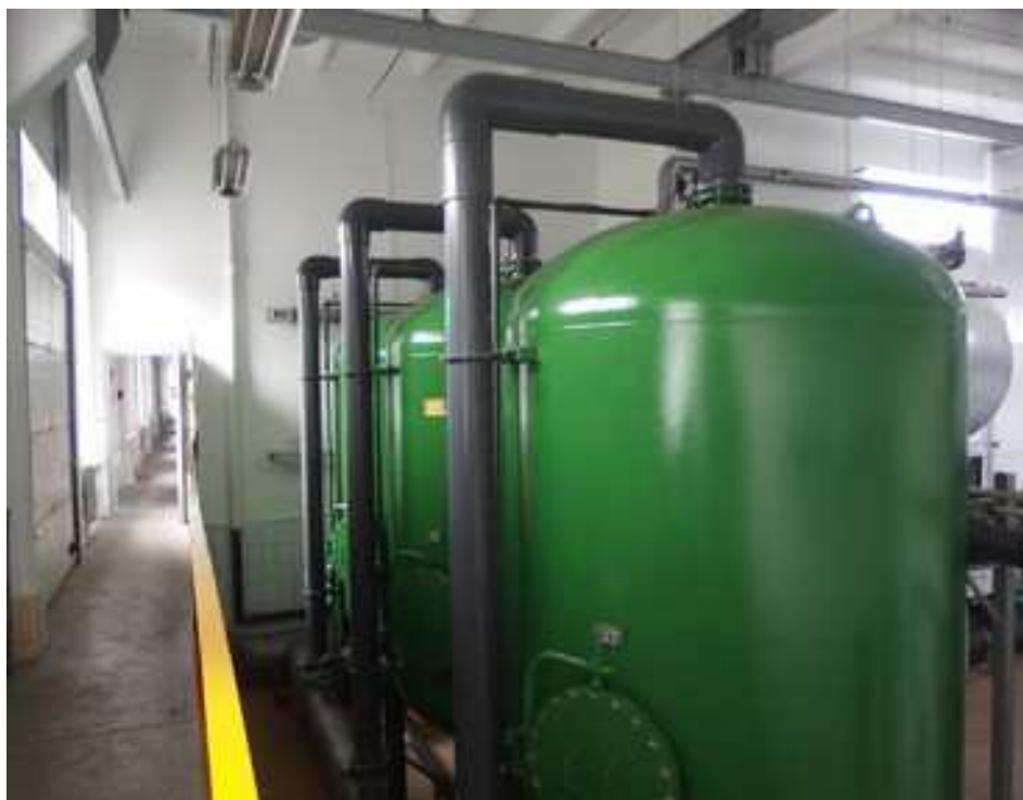
Zdjęcie 1. Układ aeratorów ciśnieniowych na SUW Graniczna
