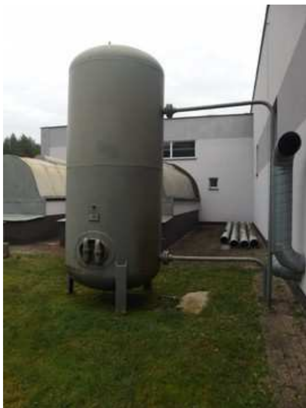
Zdjęcie 3. Zbiornik akumulacyjny na SUW Graniczna
