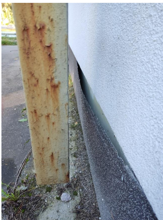
Rys. 13 Cokół pasa fundamentowego – odspojenie tynku mozaikowego
