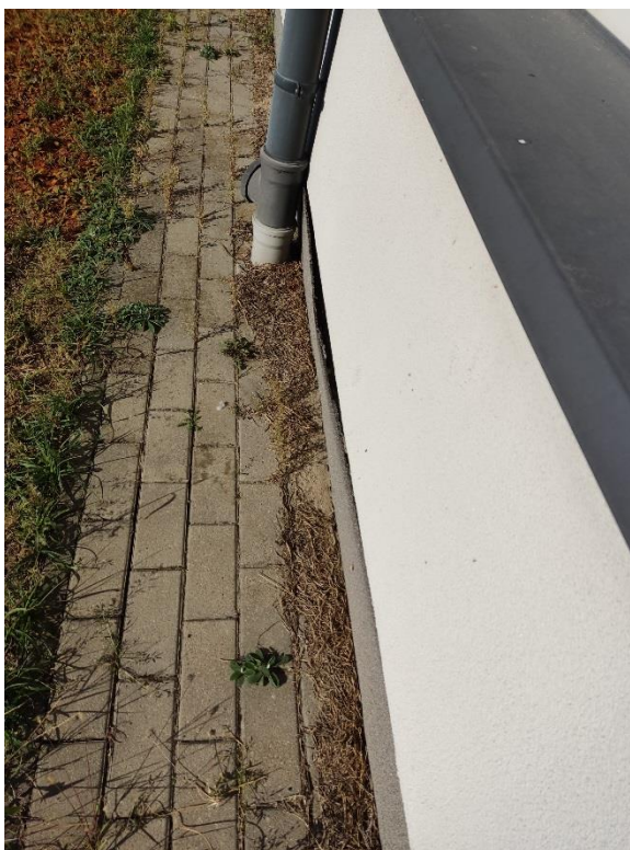
Rys. 12 Cokół pasa fundamentowego – odspojenie tynku mozaikowego
