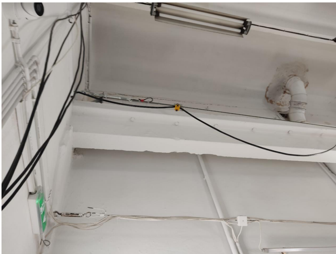
Rys. 8 Wnętrze hali filtrów – widoczne nieszczelności przy kanale wentylacyjnym i kanalizacji
