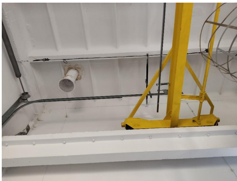
Rys. 9 wnętrze hali filtrów – widoczne zacieki przy kominku wentylacyjnym
